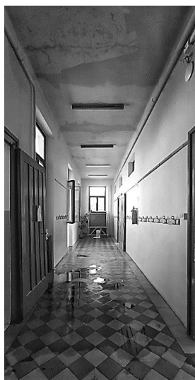
Dettaglio pavimento del corridoio al primo piano con acqua piovana e relativo soffitto visibilmente bagnato
