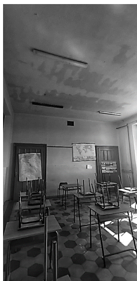
Dettaglio soffitto classe al primo piano visibilmente bagnato
